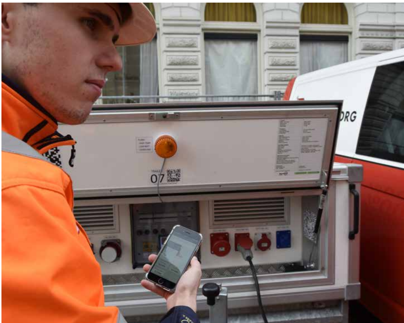
Een aantal van onze torenkranen draait een hele dag op stroom met behulp van een accucar of bouwstroom.
